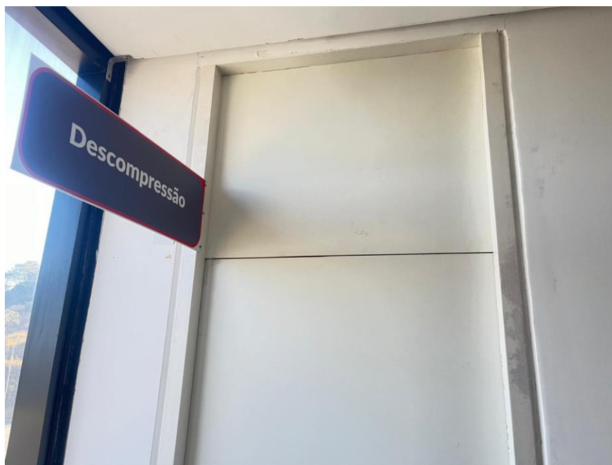
Figura 2 - Sala de descompressão.
